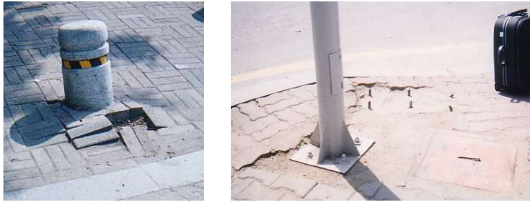
그림 4.28 도시환경장치물의 설치 시 부주의를 보여주는 사례
