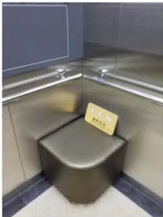
엘리베이터 내부에 설치된 스툴
