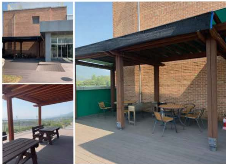
단차없이 바닥을 마감하고, 가림막 설치 및 휠체어 접근이 가능하도록 좌석 배치를 고려한 옥외 휴게공간
