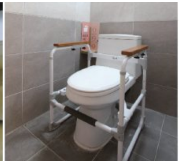
[그림110] 안전손잡이를 적용한 화장실
