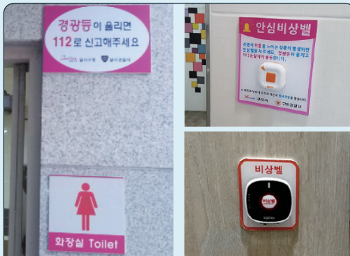
손이 닿기 쉬운 위치에 안심비상벨 설치
