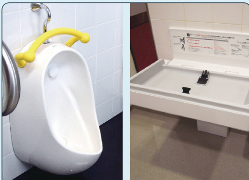
어린이의 신체특성에 맞는 위생기구와 접이식 영유아 기저귀 교환대 설치
