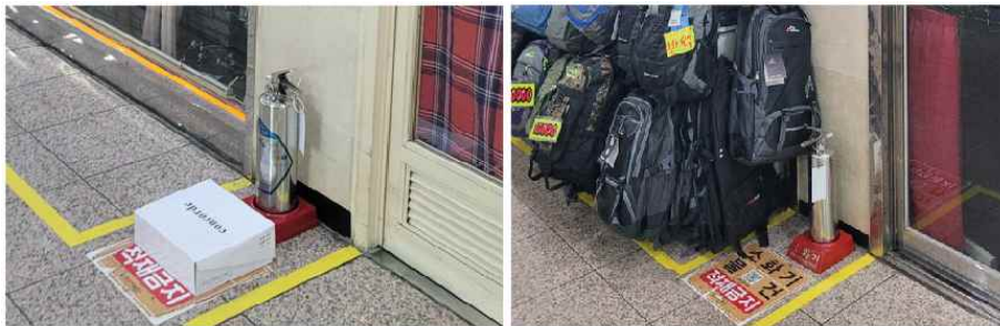
1. 파손 및 분실 요소가 있는 바닥에 배치된 소화기 2. 주변환경에 의한 가독성 및 직관성 부재로 활용성 저하
