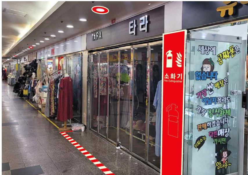
그림 4.8 소화기 위치 표시 예시(안) 벽부형, 상부형
