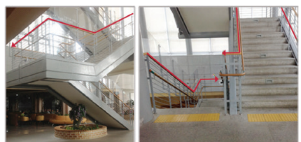
계단의 측면 손잡이를 연속으로 설치한 사례 사진
