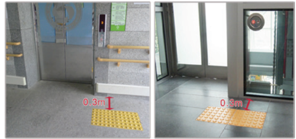
호출버튼 0.3m 전면에 점형블록을 설치한 사례 사진
