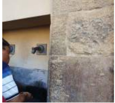
유네스코 문화 지역에 설치된 공동 식수대 ©김향경
